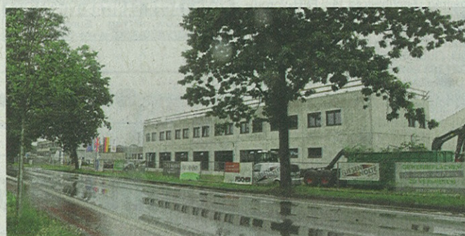
Das neue Gesundheitszentrum „Senne aktiv“ entsteht an der Gütersloher Straße unweit des Schnäppchen-Marktes.
